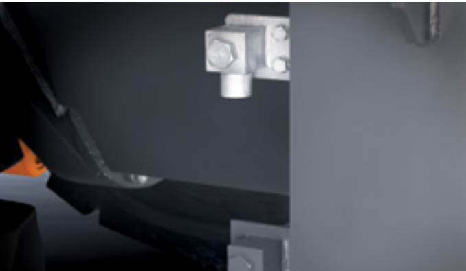
Drenos Remotos do Óleo do Motor e do Líquido de Arrefecimento Foram instaladas válvulas remotas de drenagem em local acessível para conveniência na execução da drenagem dos fluidos. (Líquido de arrefecimento - superior, Óleo do motor - inferior)
