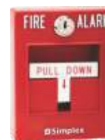
Estações manuais convencionais de acionamento de alarme
